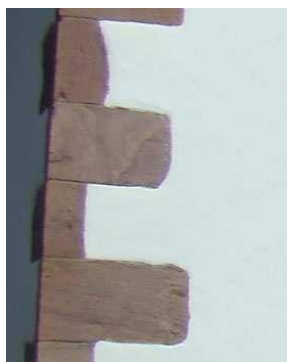
Le chaînage de pierre traditionnel, en grès rose avec un enduit venant à fleur de la pierre de taille
